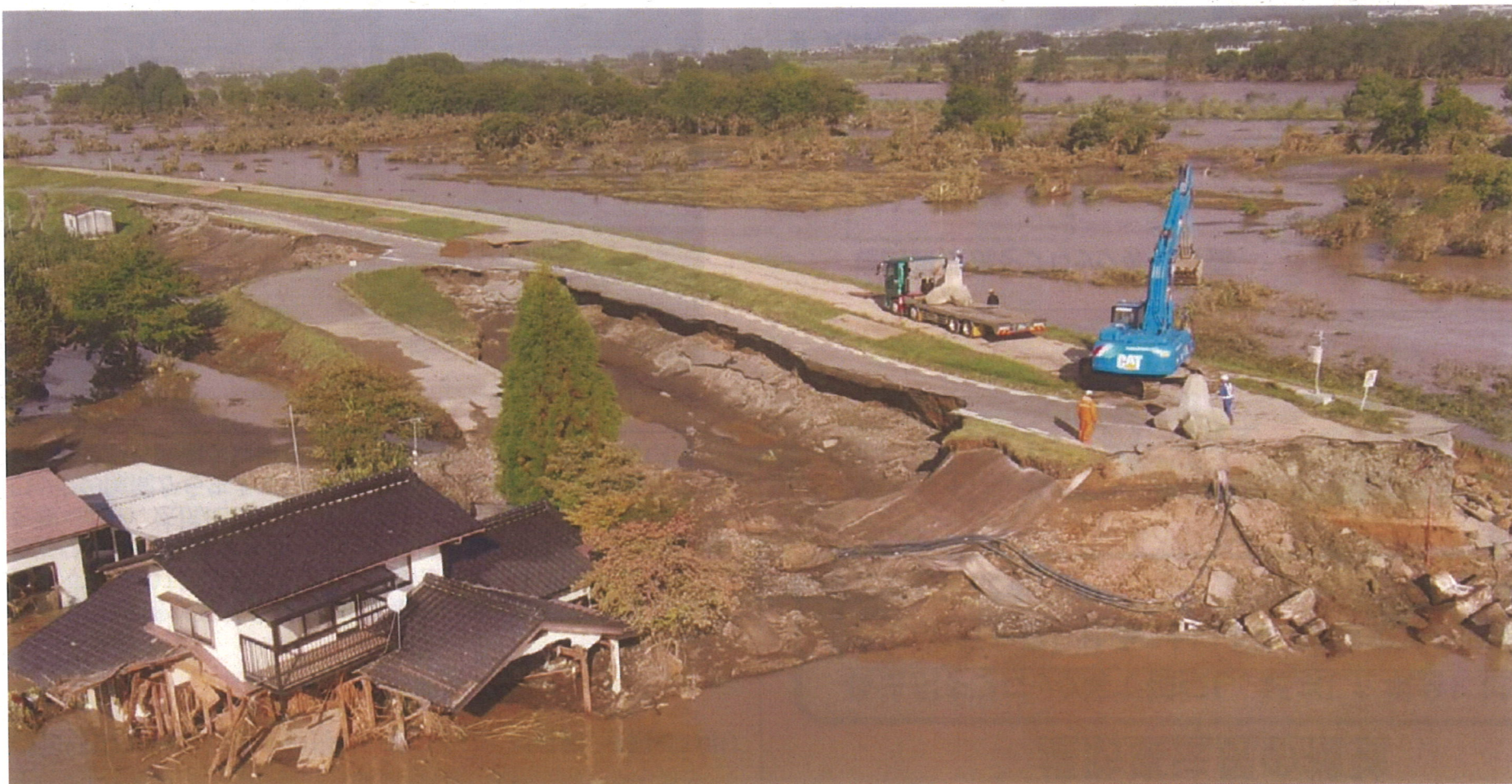
千曲川左岸57.5k付近の決壊箇所
